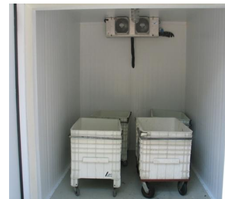
Câmara fria Abrigo de Resíduos
